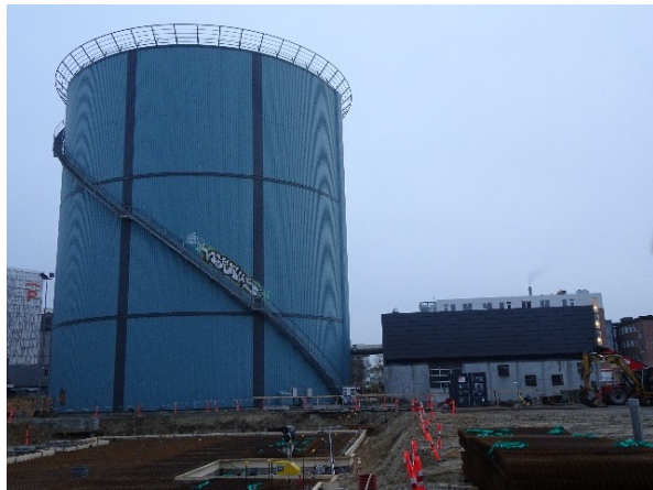
1. 蓄熱槽(1.2万m 3 )と ポンプ室
