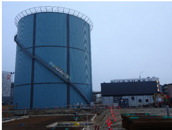
1. 蓄熱槽(1.2万m3)と ポンプ室
