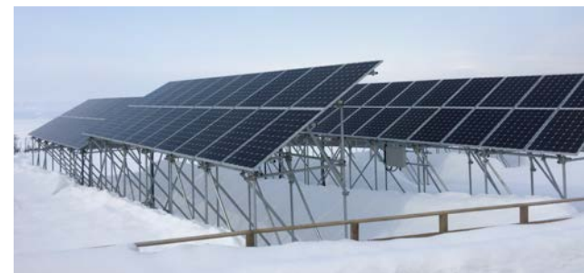
冬期間の雄国発電所
